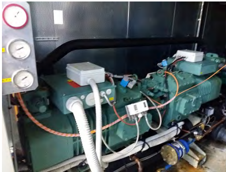
EQUIPO FRIO 300.000 FRS INSTALADO EN CONTAINER (ENFRIADOR AGUA) 12.000,00 €
